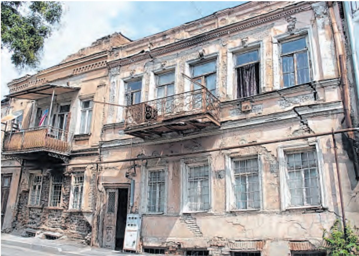
■ Wenige Straßenzüge vom Zentrum entfernt stehen Hausruinen, doch immer mehr von ihnen werden renoviert.
